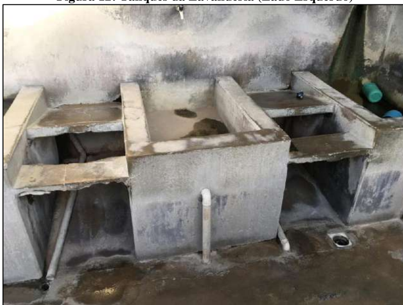
Figura 12: Tanques da Lavanderia (Lado Esquerdo)
