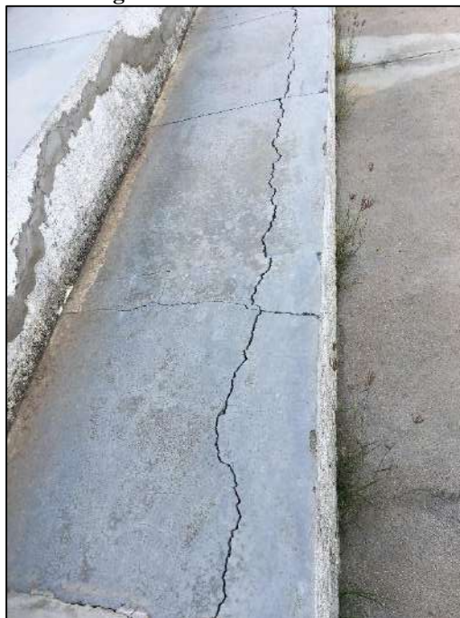
Figura 09: Trinca e Fissuras
