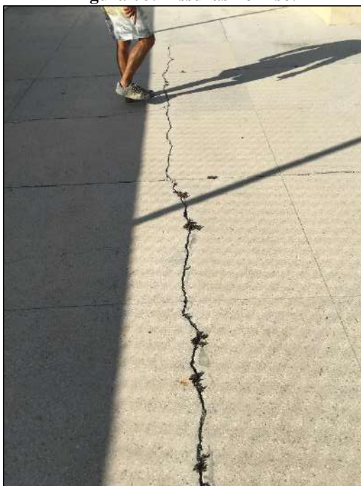
Figura 08: Fissuras no Piso.
