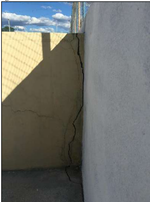
Figura 07: Trinca Parede Interna Lado Direito
