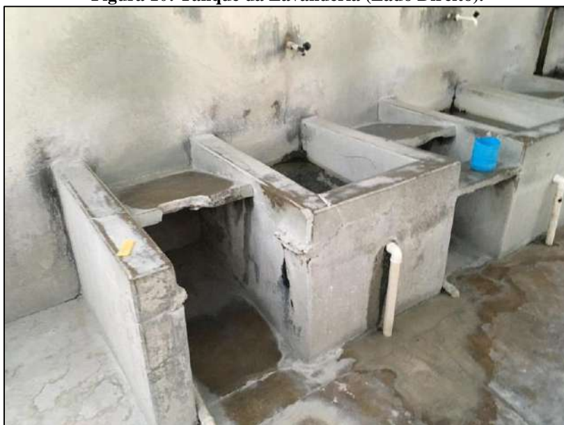
Figura 10: Tanque da Lavanderia (Lado Direito).
