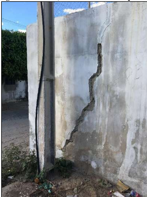
Figura 04: Trinca, Fachada Lateral Esquerda.
