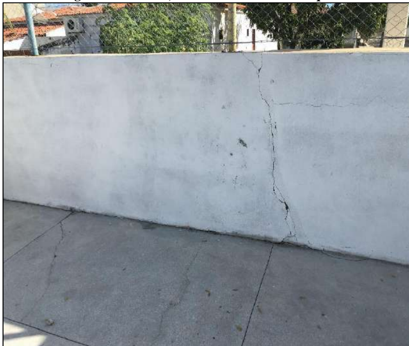
Figura 09: Fissura, Parede Interna Lado Esquerdo
