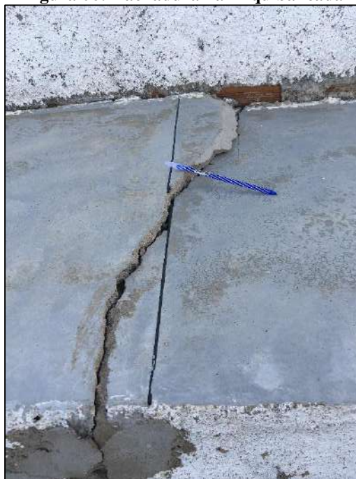
Figura 06: Rachadura na Arquibancada
