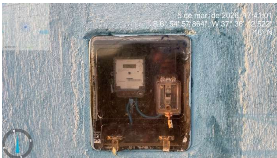
Foto 09: Fornecimento de energia elétrica em imóvel adjacente
