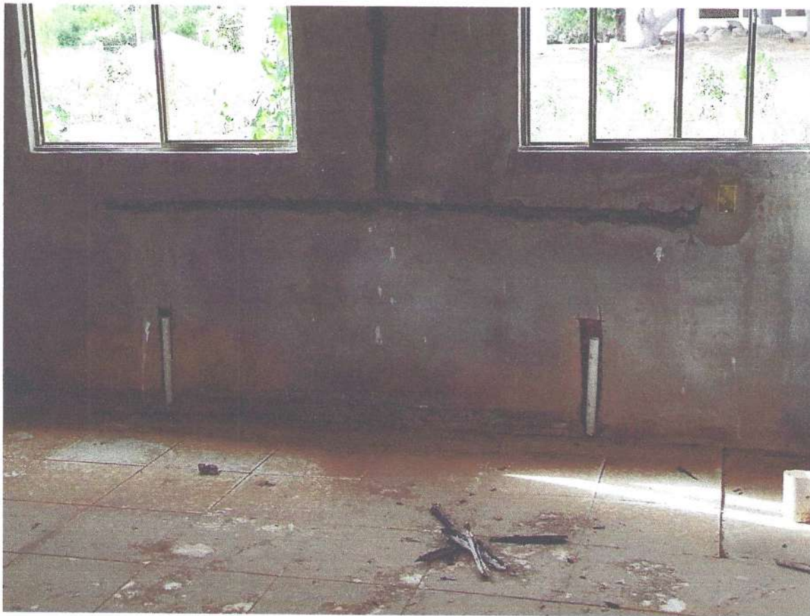
FIGURA 13: Detalhe de instalações hidrossanitárias e elétrica de pia no interior do bloco de serviços
