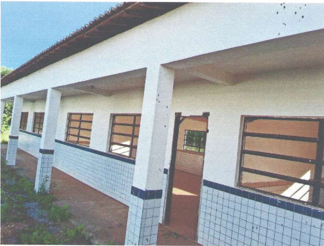
FIGURA 06: Piso cerâmico coberto por lama seca.
