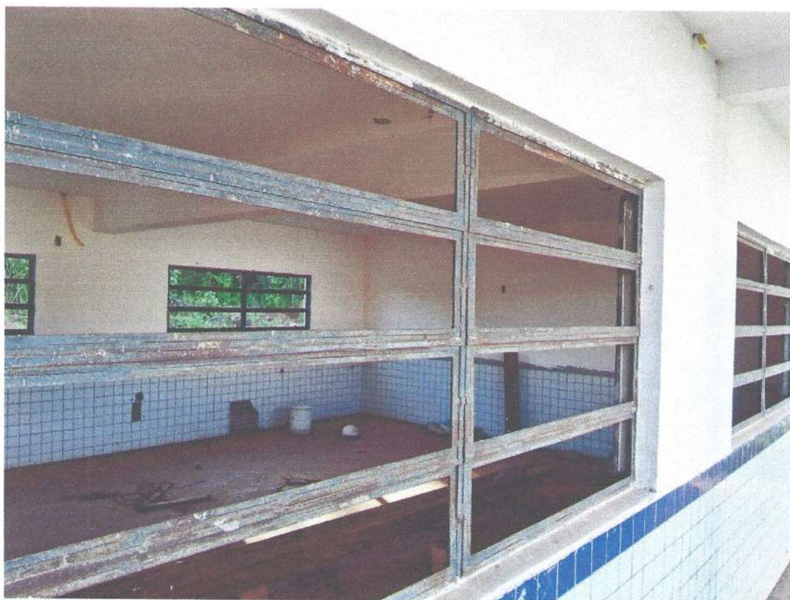
FIGURA 07: Esquadrias com início de oxidação (necessidade de lixamento, aplicação de pintura anticorrosiva antes de aplicação de esmalte)
