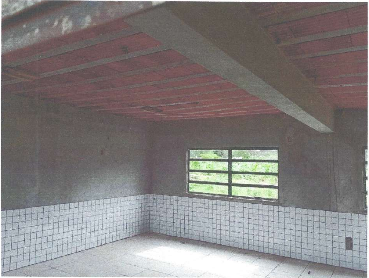
FIGURA 08: Vista interna de uma sala de aula onde a laje apresentou flecha excessiva, necessidade demolição e reconstrução da laje dessa sala de aula.
