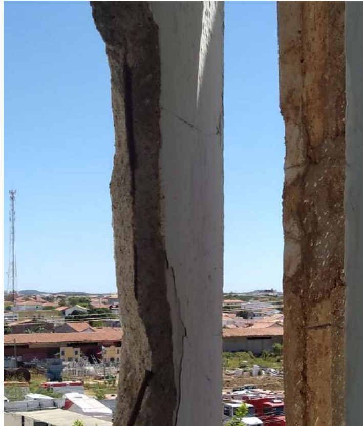
Figura11- Perda da seção de concreto do brise
