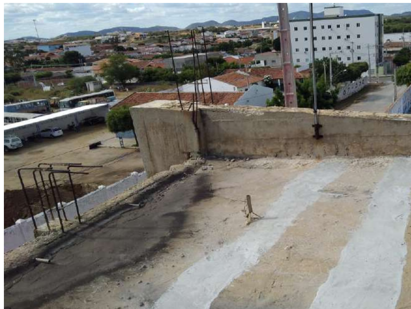
Figura 21 – Esperas de armadura expostas às intempéries
