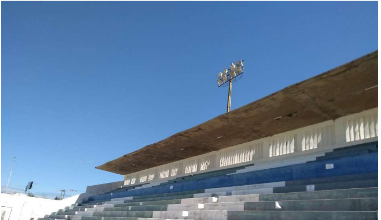
Figura 6- Deformação das lajes da marquise
