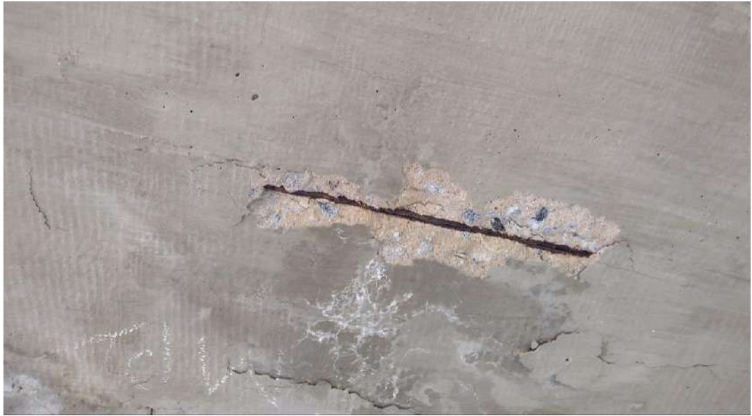
Figura10- Detalhe da armadura exposta com corrosão
