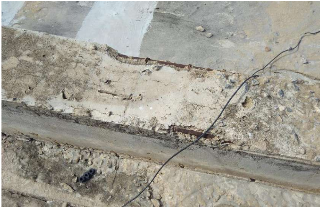
Figura 18- Fissuras nas vigas
