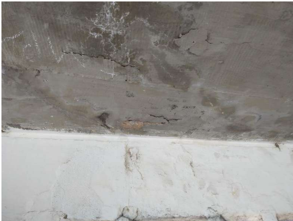
Figura 9- Fissuras e deslocamento do concreto devido à corrosão
