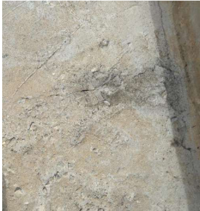
Figura 14 – Fissura no meio do vão da laje, na face superior
