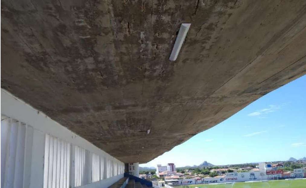
Figura 8- Corrosão nas lajes da marquise – vista geral
