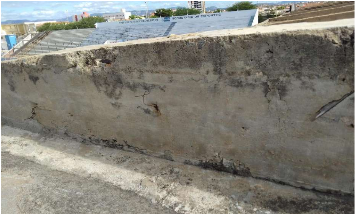
Figura 20 – Juntas de concretagem visíveis
