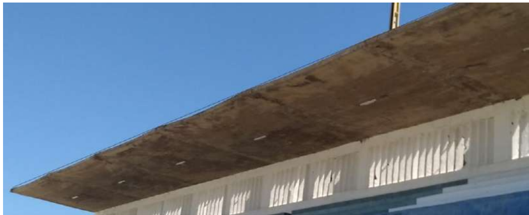
Figura 7- Deformação das lajes da marquise
