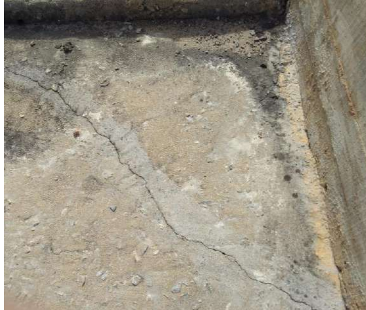
Figura 13- Fissuras na face superior no canto das lajes
