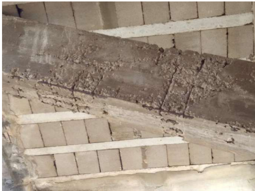
Figura 25 – Viga com concreto segregado e adensamento insuficiente
