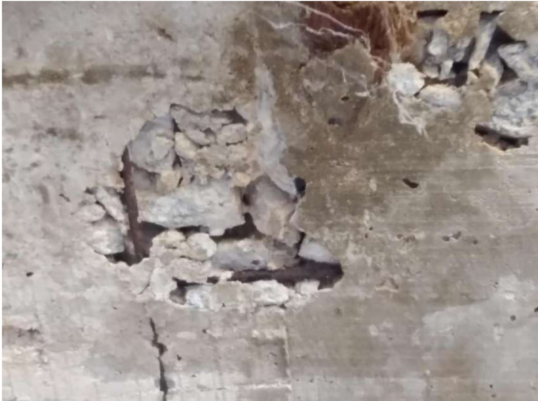
Figura 26 – Detalhe de peça com concreto segregado e com adensamento inadequado
