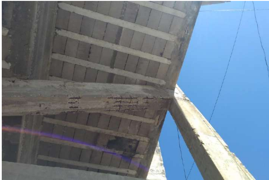
Figura 24 – Viga com concreto segregado e cobertura inadequada da armadura
