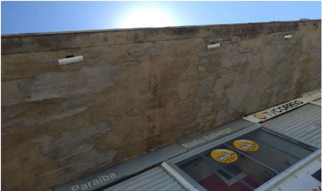
Figura 12(a)- Reparos antigos efetuados nas lajes
