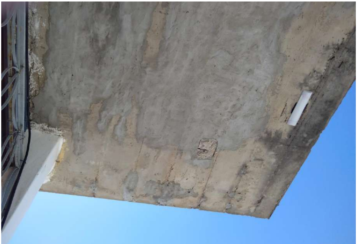
Figura 12(b)- Reparos antigos efetuados nas laje, na região das cabines
