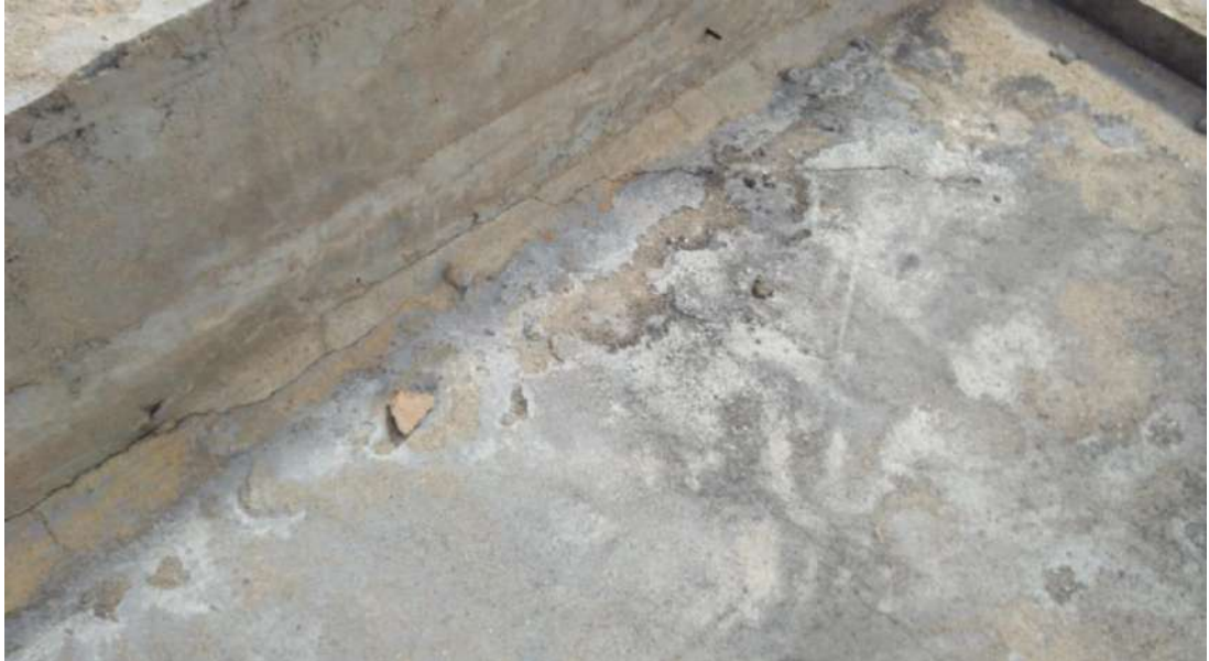
Figura 15 – Fissura na laje ao longo da viga
