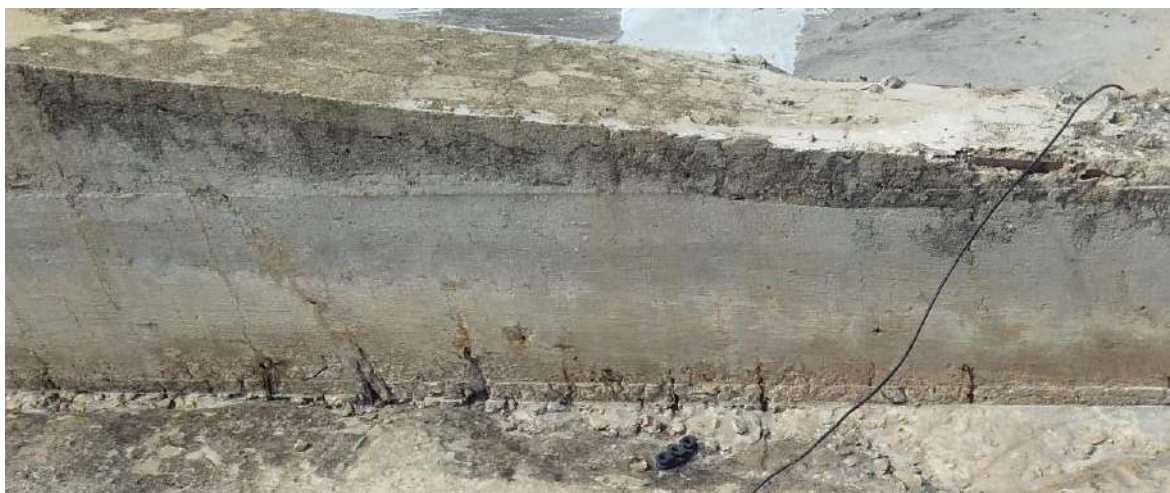
Figura 19 – Armadura das vigas com sinais de corrosão
